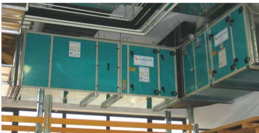
Klima-komore u proizvodnom dijelu
