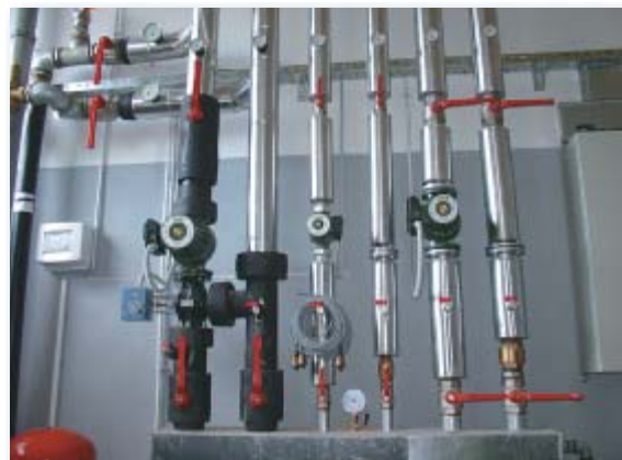
Instalacije u kotlovnici
