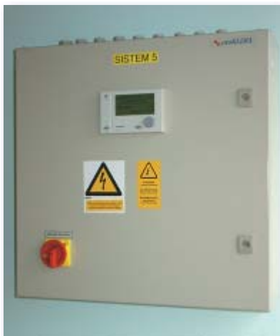
Jedan od 6 upravljačkih ormara za klima-komore
