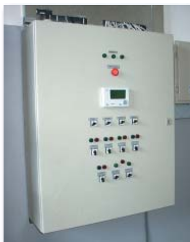
Centralni upravljački ormar u kotlovnici
